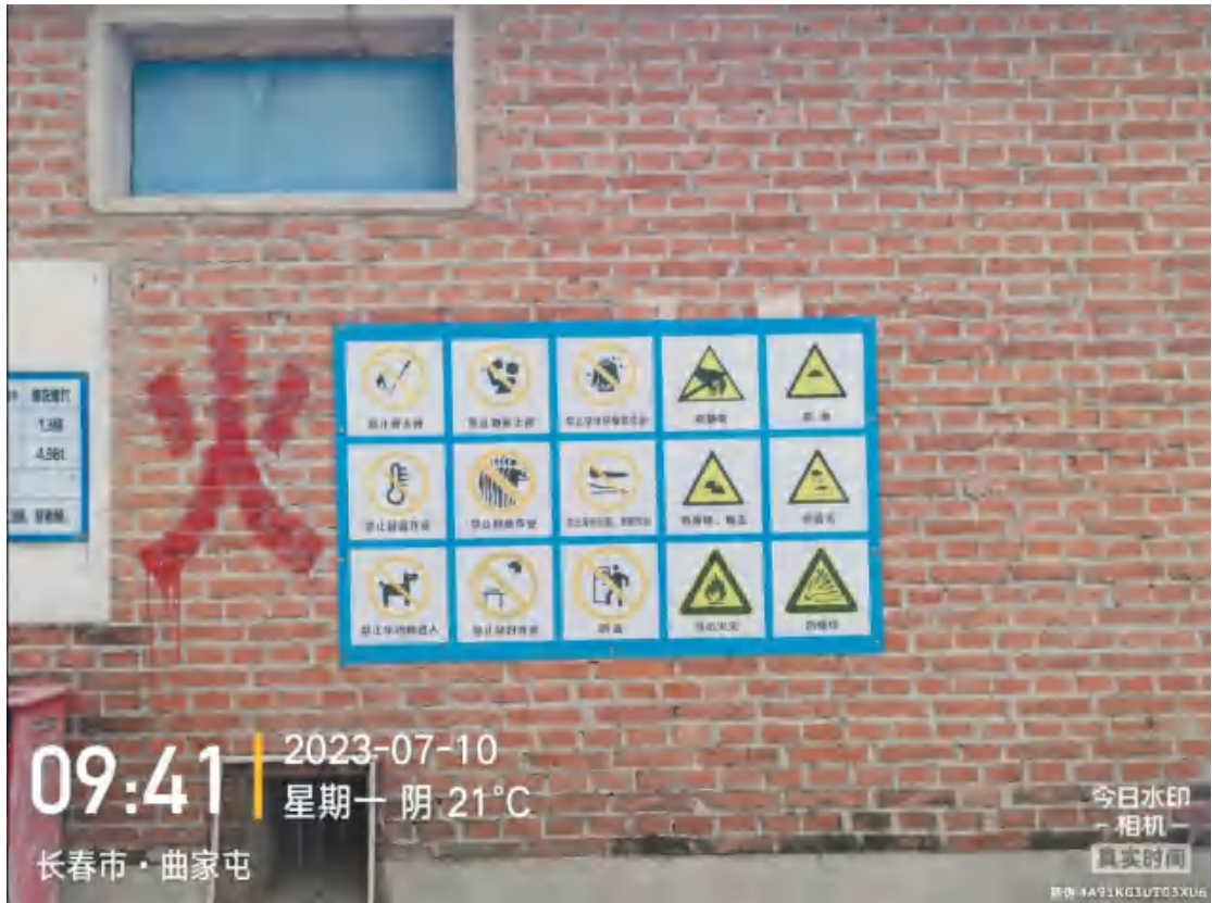
整改前：库区安全警示标识褪色
